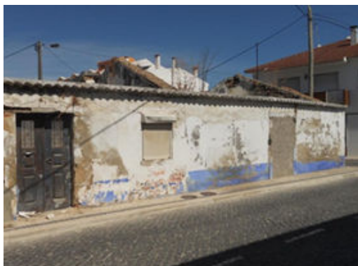
Figura 1 – Edifícios em ruína no interior da ARU. Rua da Alagoa
