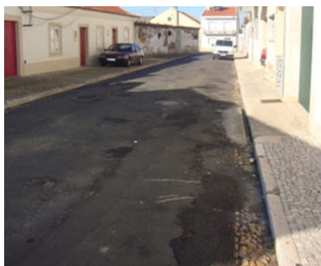
Figura 5 – Rua dos Apóstolos, com o pavimento em mau estado de conservação
