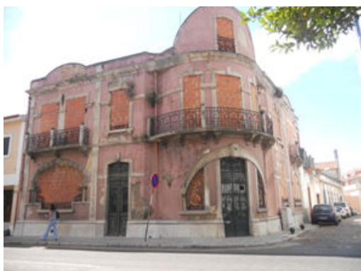
Figura 3 – Edifício em avançado estado de degradação. Rua Dr. Francisco Nunes Godinho
