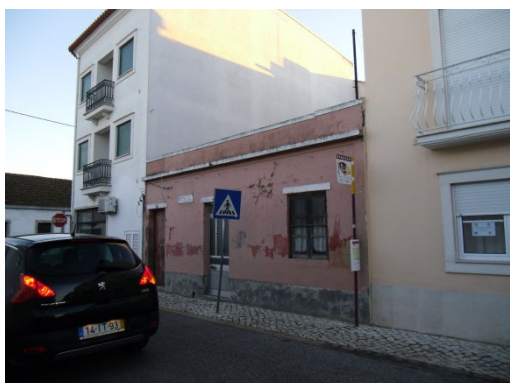
Figura 3 – Edifício em mau estado de conservação
