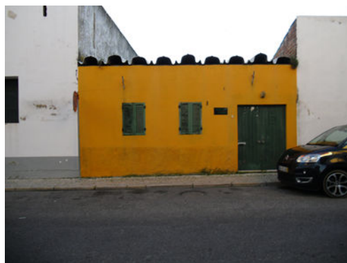
Figura 6 – Exemplo de edifício sem qualidade arquitetónica e em mau estado de conservação
