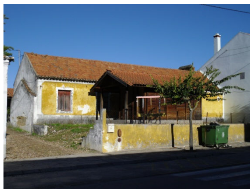
Figura 7 – Edifício em avançado estado de degradação
