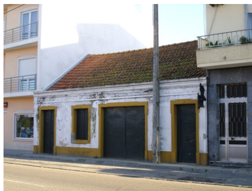
Figura 7 – Edifício em mau estado de conservação
